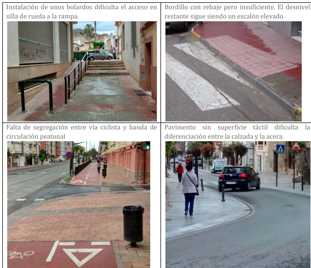
Figura 97: Fallos de ejecución en obras de mejora de la accesibilidad
